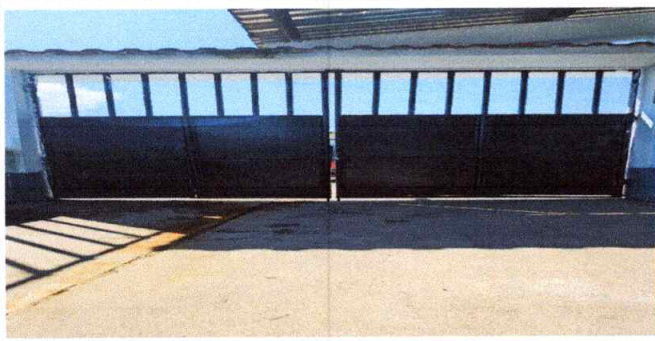
Foto1: Sustrucción de portón metalico.
