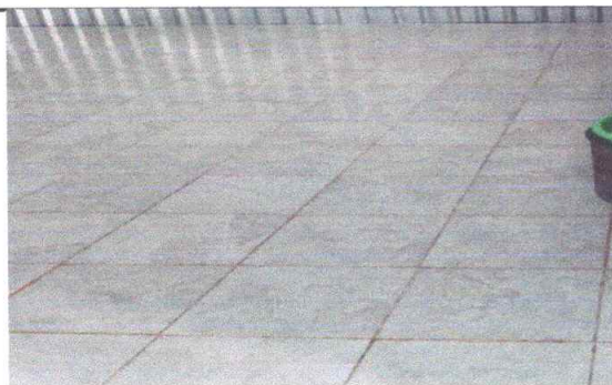
Foto No. 11 piso con cerámico en cocina
