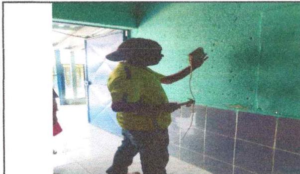
Foto No. 5 Sustrucción de cableado eléctrico No.10
