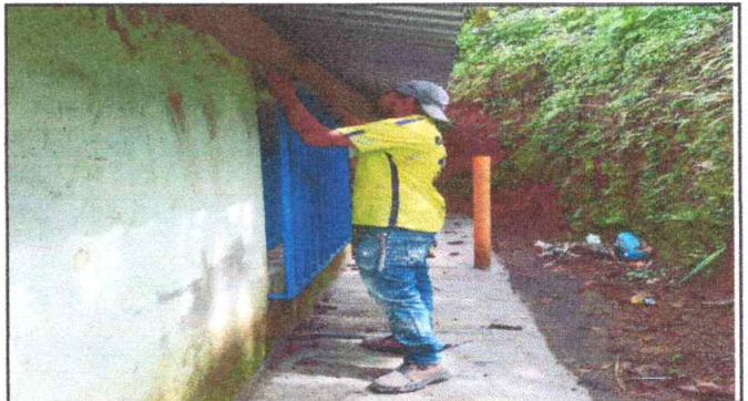
Foto No. 4 Sustrucción de balcones en ventanas de metal
