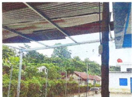
No 3. SUSTITUCION DE ENERGIA ELECTRICA FUERZA E ILUMINACIÓN
