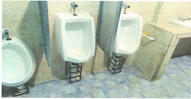
Foto 6: Sustrucción de mingitorio
