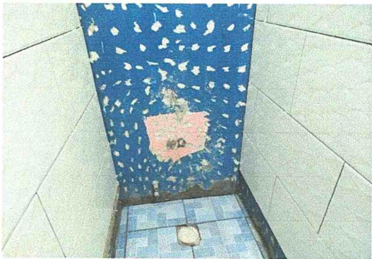
Foto 4: Sustrucción de azulejo
