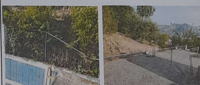
Sustitución de malla por barandas de circulación con puntas, porque sobre la malla entran niños en diferentes puntos
