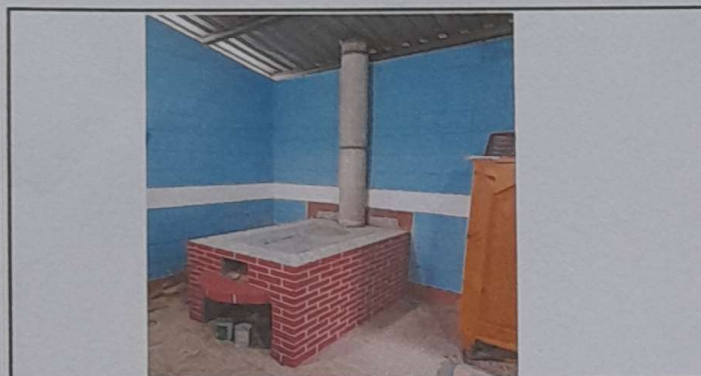
Foto 3: Estufa en cocina escolar, módulo 1
