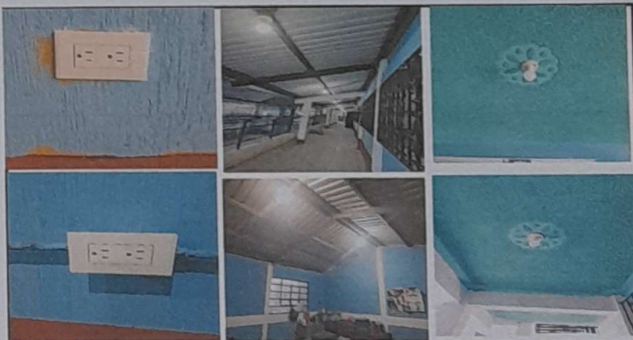
Foto 4: Sistema eléctrico en aulas 2do nivel, primer nivel y dirección, módulo 1
