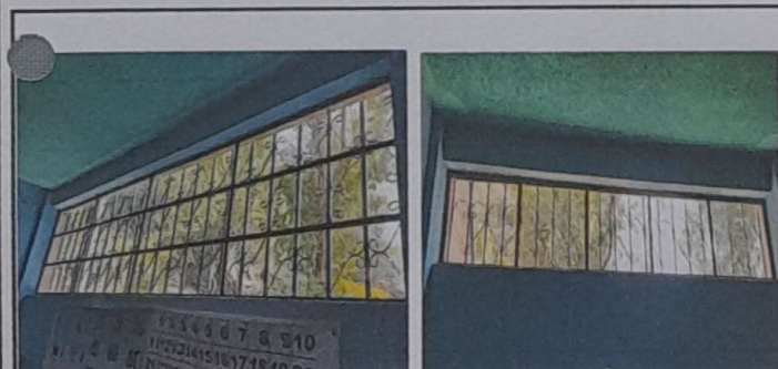
Foto 5: Vidrios en aulas y dirección, módulos 1
