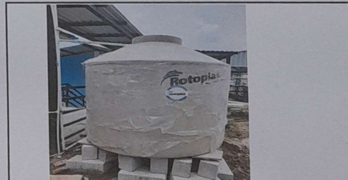
Foto 6: Depósito de agua de 2500 litros, módulo 1
