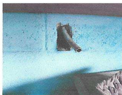
Sistema eléctrico en cocina
