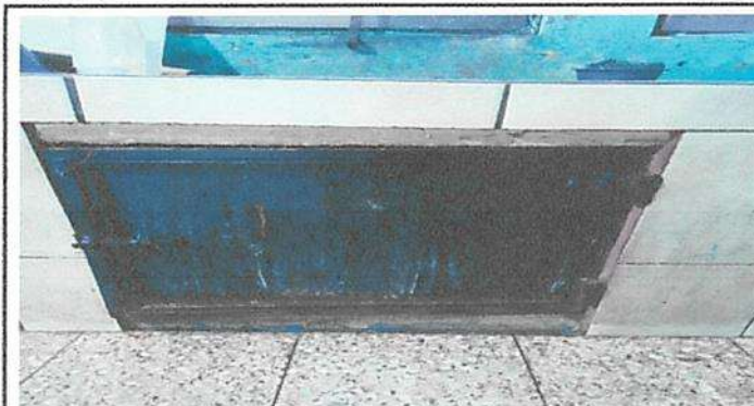
Mantenimiento de puerta de gabinete
