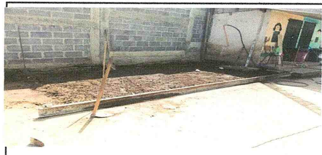
Foto 6: Sustrucción de piso de torta de concreto
