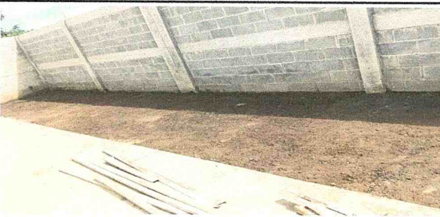
Foto 5: Sustrucción de piso de torta de concreto
