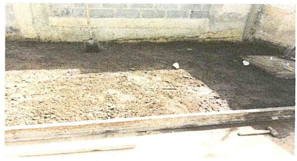
Foto 4: Sustrucción de piso de torta de concreto
