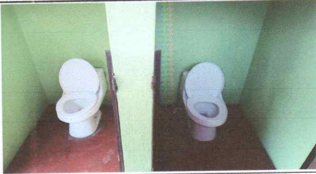
2 unidades de Sustitución de sanitarios institucionales + accesorios
