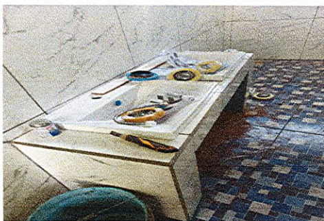
Foto 5: Sustrucción de lavamanos rectangular sobrepuesto.
