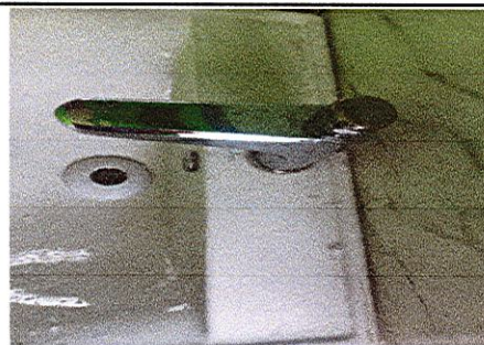
Foto 6: Sustrucción de grifo con push.
