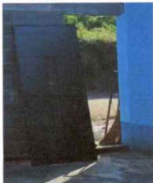
Foto1: Sustrucción de Puerta de metal incluye chapa yale
