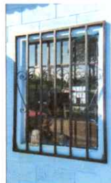
Foto 4: Metros cuadrados de Sustrucción de balcón de metal de reja
