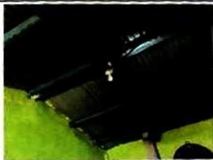
Mantenimiento correctivo de estructura portante metálica con pintura y daños
