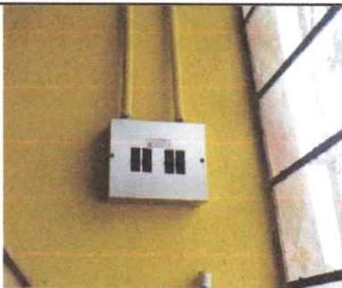
1 unidad de Sustitución de tablero de distribución de energía para 4 circuitos
