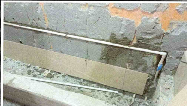
Sustitución de azulejo en mingitorio en baño de niños
