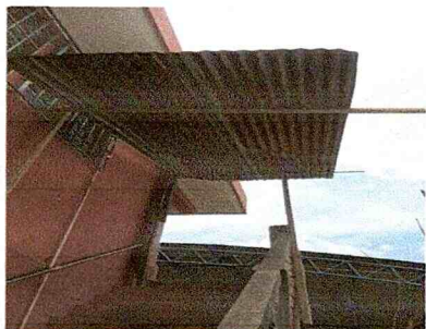
Foto 1: Sustrución en estructura de soporte en baños con material galvanizado
