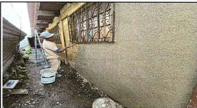
Repello en muro exterior
