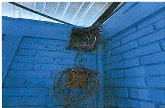
Substitucion de Tablero general de Distribución de 16 circuitos marca G.E. y suministro de energia.
