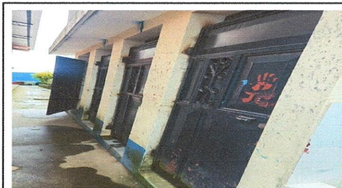
Mantenimiento estructura metalica mal estado en puertas de baños (incluye lijado y pintado )
