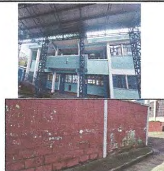
Mantenimiento de muro con aplicación de pintura en mal estado en muro perimetral y en edificio de dos plantas de aulas de modulo 1.
