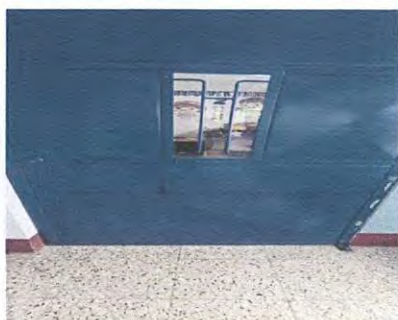
MANTENIMIENTO DE ESTRUCTURA METÁLICA EN MAL ESTADO EN PUERTAS,
