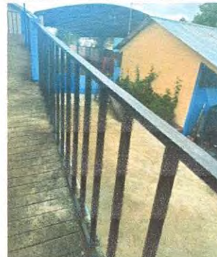
Mantenimiento de pintura en mal estado de barandas en pasillos de aulas
