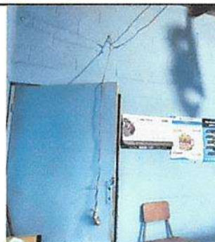
Suministro interruptor simple
