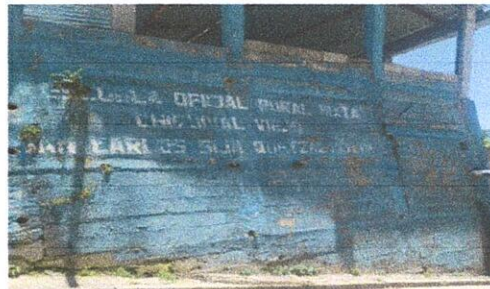
Longitud Critica De Muro fisurado 6.50 metros lineales
