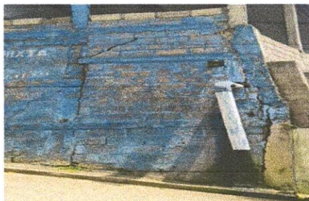
El muro posee Grietas debido a Sismos
