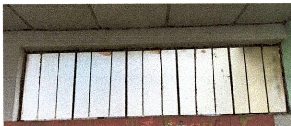
Módulo 1. Modificación de ventanas metálicas a corredizas, ventanas que no se pueden abrir.
