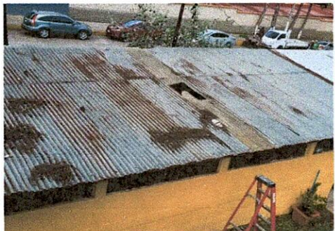
Módulo 1. Sustitución de láminas por láminas troqueladas calibre 26, lámina oxidada en mal estado,
