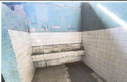
Mantenimiento de mingitorios en área de módulo de sanitarios 2.
