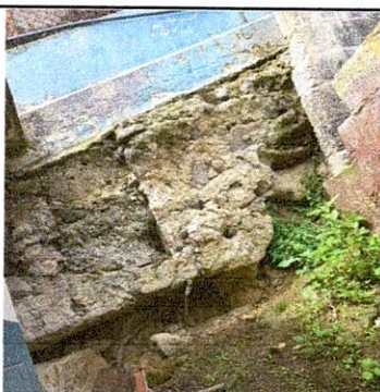
Asentamiento de la base de cimentación
