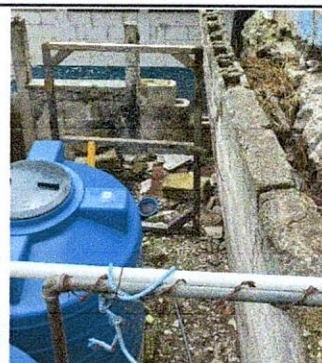
Sustitución de muro de contención: Presenta desplazamiento de verticalidad
