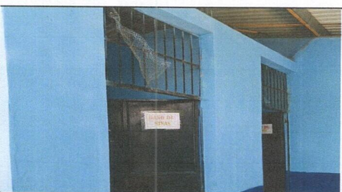
Foto: 4 MATENIMIENTO A BALCONES METALICOS
