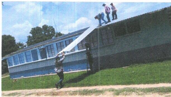
Foto2: SUSTITUCIÓN DE CAPOTE DE LÁMINA PARA LAMINA TROQUELADA
