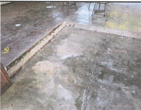
Foto 3: Sustrucción de piso de torta de concreto
