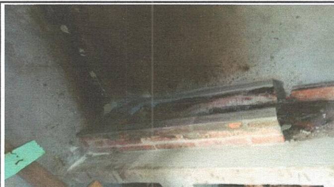
Foto 1: SUSTITUCION DE ESTUFA RURAL
