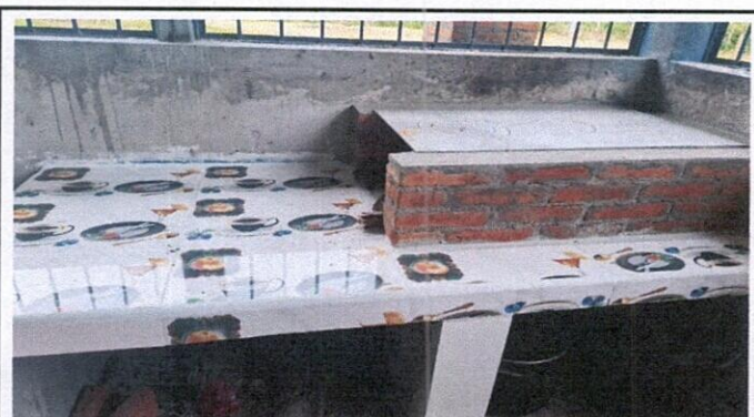
Foto 4: SUSTITUCION DE ESTUFA RURAL
