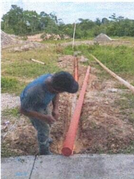
Foto 3: RED DE DRENAJE
