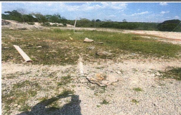
Foto: 3 RED DE DRENAJE
