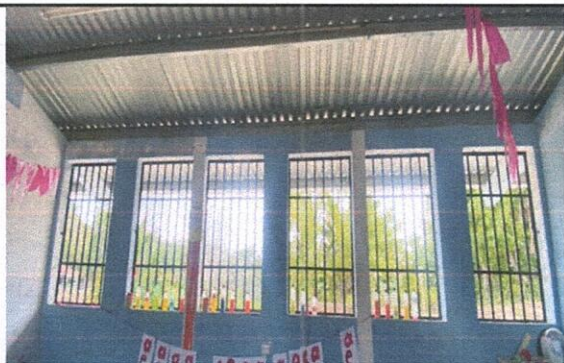
Foto: 5 VENTANAS DE PVC
