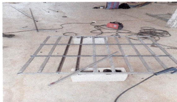
Foto 4: Sustrucción de balcon de metal
