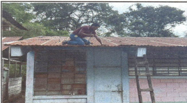
Foto1: CAMBIO DE TECHO, AQUÍ LOS TRABAJADORES ESTÁN QUITANDO LAS LAMINAS QUE ESTAN EN MAL ESTADO.
