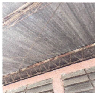
Foto 4: Techo dañado, peligroso para los niños.
