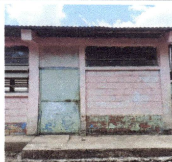
Foto 2: Dirección de la escuelita con balcones y puertas dañadas.
