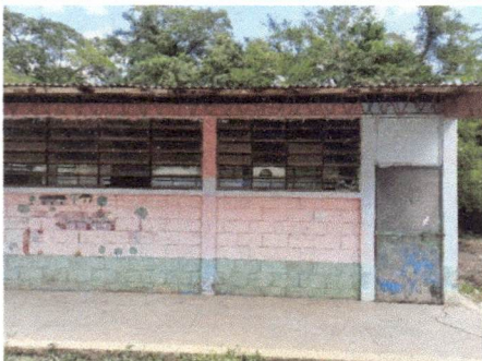
Foto 1: Parte de enfrente de la escuelita balcones, puertas dañadas.
