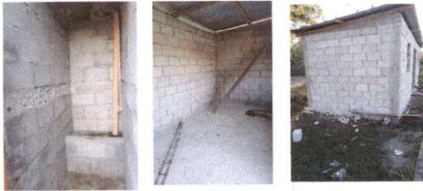
Foto1: Cernido en muros
