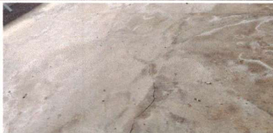
Foto 6: Sustrucción de piso de torta de concreto
