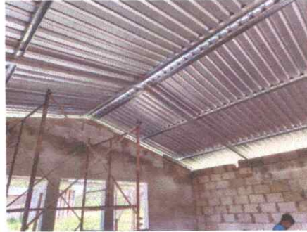
Foto 2: Sustituir su estructura de soporte de madera, por metal
