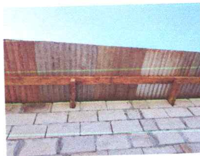
Foto: 2 Sustituir su estructura de soporte de madera, por metal
