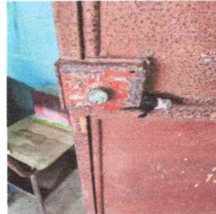
Foto 4: Sustrucción de chapas
