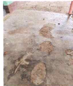
Foto 6: Sustrucción de piso por piso cerámico
