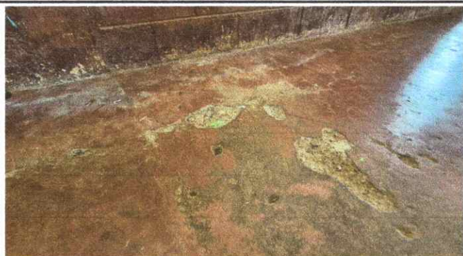
Foto 1: Sustrución de piso de torta de concreto
