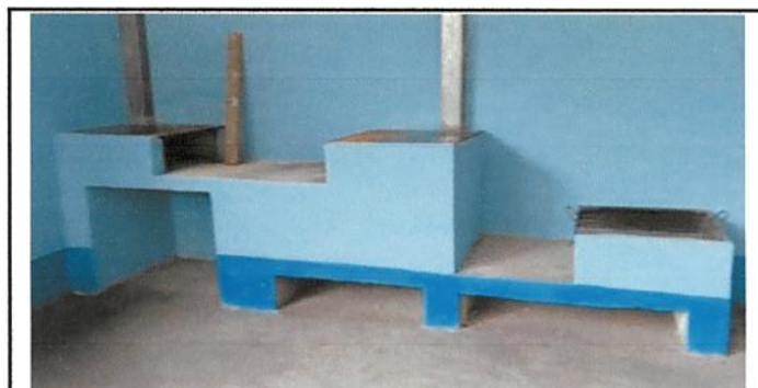
20.2 SUSTITUCION DE ESTUFA RURAL COMPLETA
