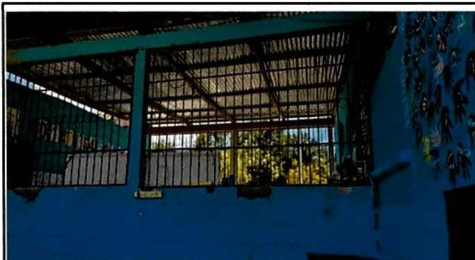
Foto 3: Sustrucción de balcón de metal
