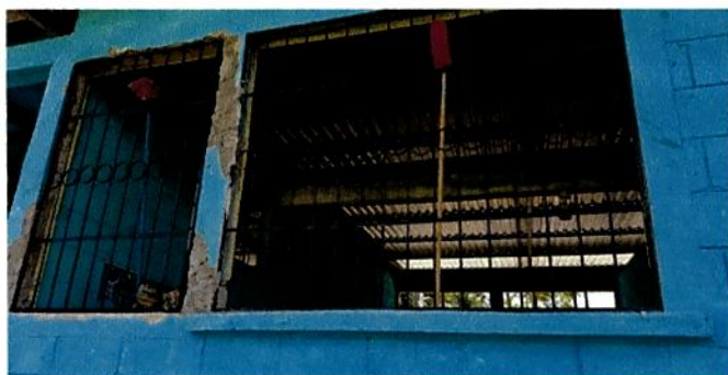
Foto 4: Sustrucción de balcón de metal
