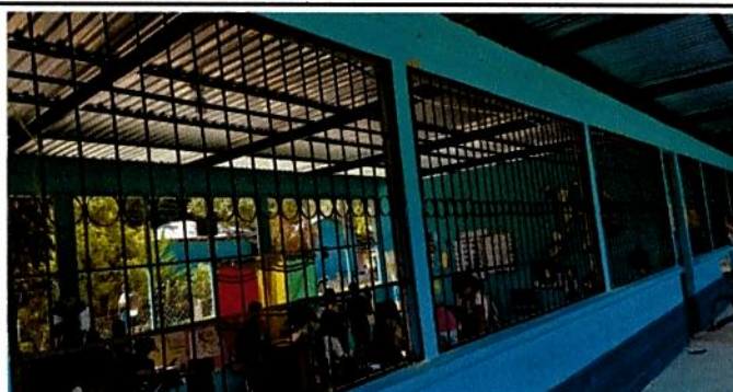
Foto 2: Sustrucción de balcón de metal
