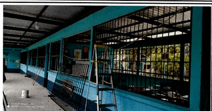
Foto 2: Sustrución de balcón de metal
