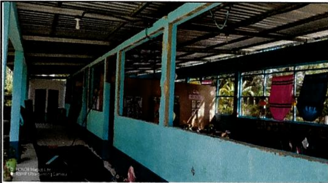
Foto 1: Sustrución de balcón de metal
