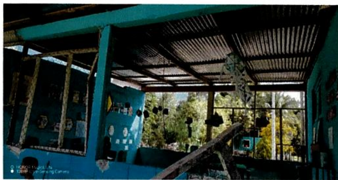
Foto 3: Sustrución de balcón de metal
