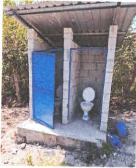
Foto 1: Sustrucción de puerta en servicios sanitarios
