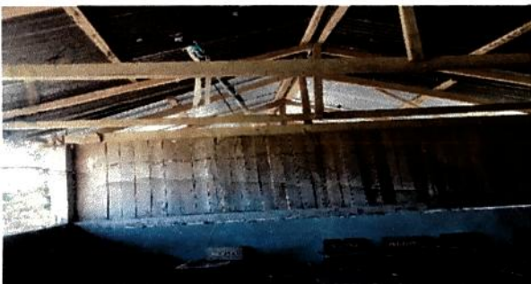
Foto 3: Se necesita cerrar la parte de atrás del aula ya que se encuentra deteriorada la madera
