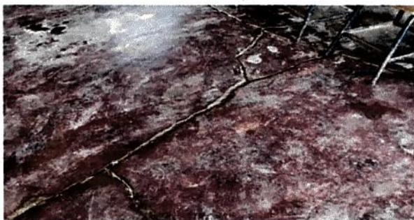
Foto 4: El piso se encuentra rajado.
