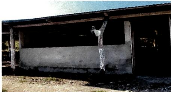
Foto 1: Se necesita balcones en la ventana de enfrente ya que se encuentra descubierta.
