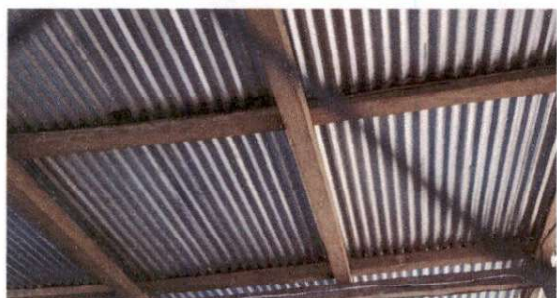
Foto 1: Sustrucciones de lamina, por lamina troquelada aluzinc calibre 26.
